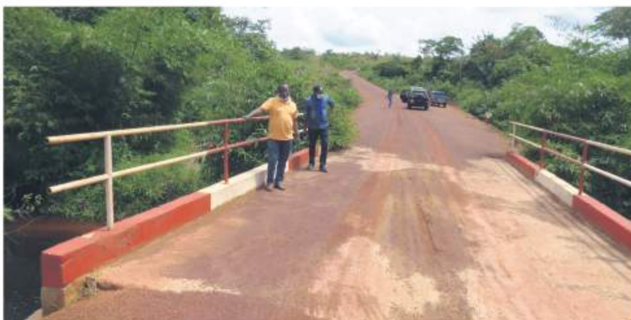
Pont sur la Loua, piste agricole Zabata Mahouobo (Bouenza), réhabilitée par la société EBCS
